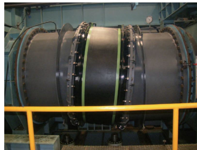
伸縮可撓管 彗星 中圧用 \phi 2000-100H 偏心試験
